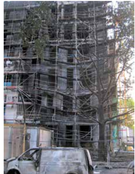
Abb. 2: Zum Schutz der Bauarbeiter und Benutzer müssen Gebäude auch in Bauzuständen ausreichend brandsicher sein
